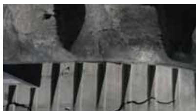
Abriss der äußeren Gummikante auf einem langen Stück
